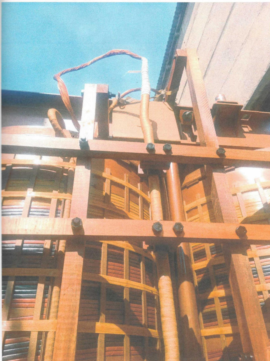
Активная часть трансформатора
